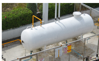
Zbiorniki gazu LPG
